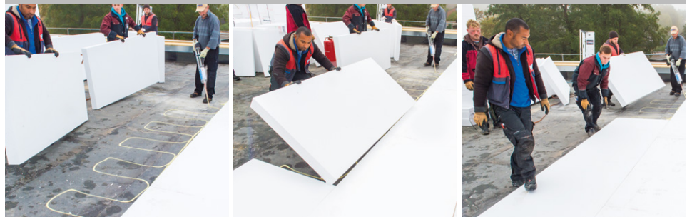
Kleber aufbringen, Styroporplatten auflegen, andrücken, sofort begehrbar - und die Arbeit kann weiter gehen.
